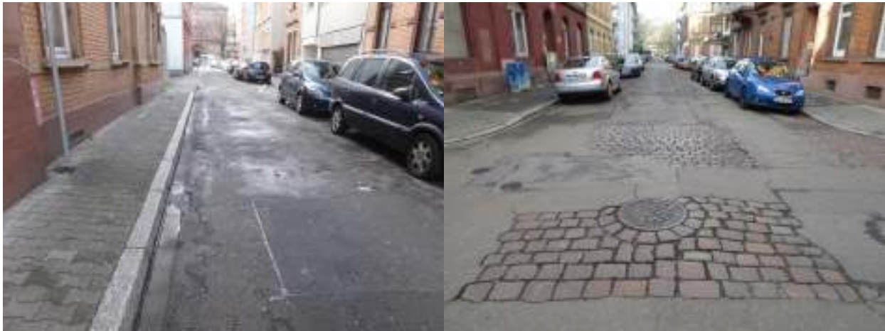
Abbildung 41: Baulich-funktionale Mängel im Straßenbelag (li. Pestalozzistraße), ursprüngliche Kopfsteinpflasterung (re. Langstraße) (Quelle: Fotodokumentation)
