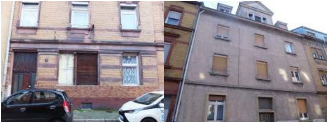
Abbildung 22: Gebäude mit deutlich sichtbaren baulichen Mängeln und (vermutetem) umfassenden Sanierungs- und Modernisierungsbedarf (Quelle: Fotodokumentation)
